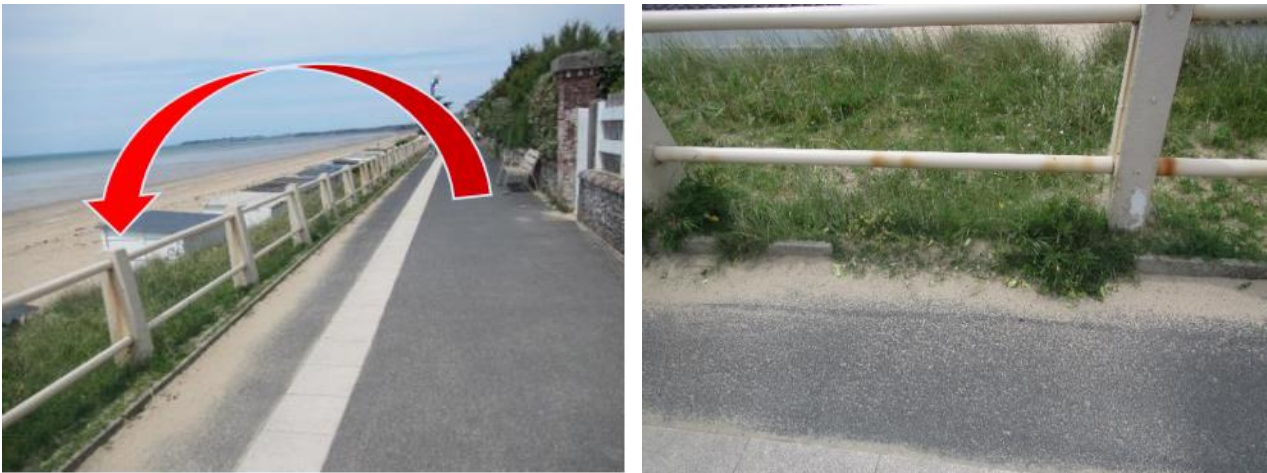
Figure 4-9 : Affaissement de la promenade à gauche et bordure endommagée à droite (Source : ISL)
