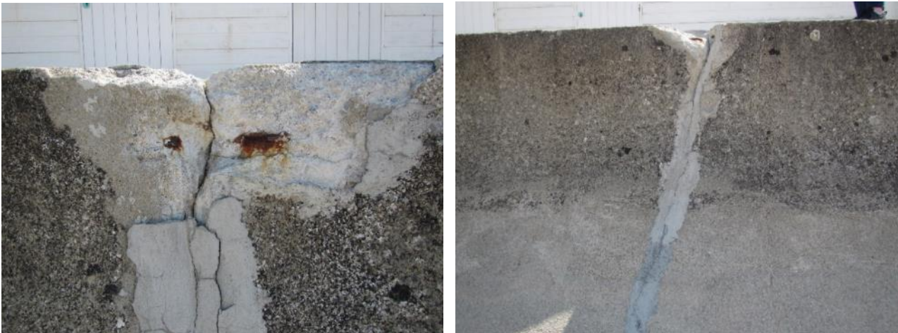
Figure 4-1 : Fissures, déstructurations, aciers apparents et traces de corrosion (Source : ISL)
