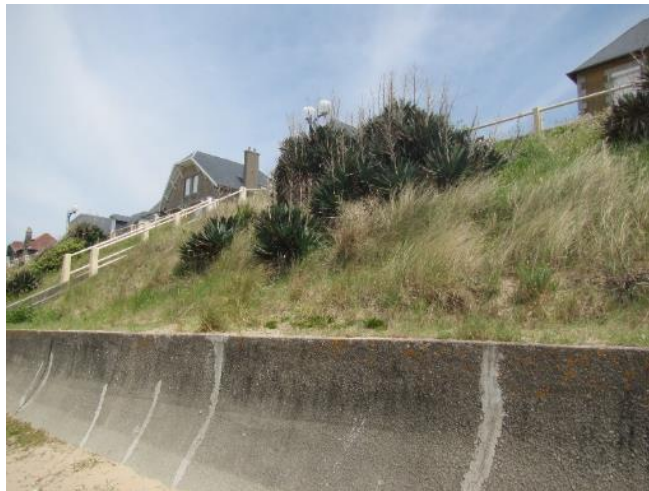
Figure 4-4 : Végétation sur la partie Nord de la digue (Source : ISL)
