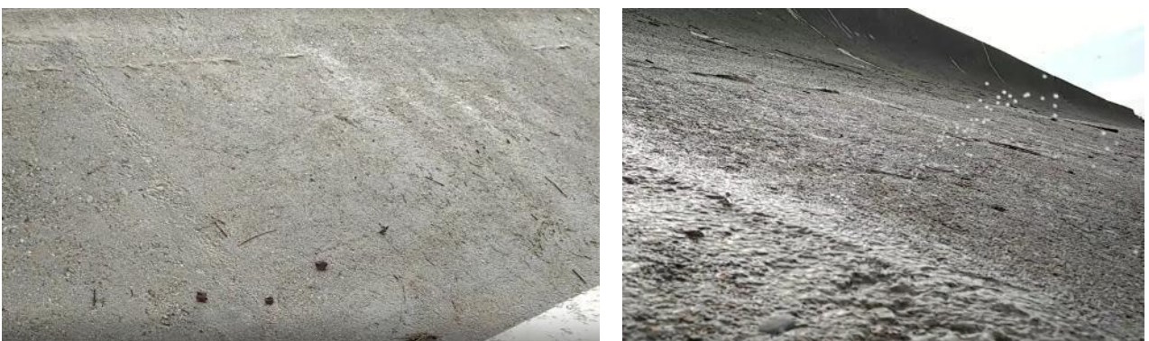
Figure 2-8 : Suintements et fuites d'eau au travers de l'ouvrage [8]
