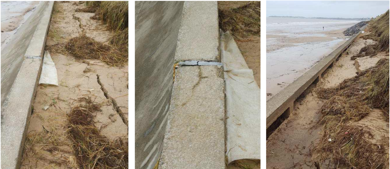
Figure 2-6 : Etat de l'ouvrage après les premiers assauts de la tempête à marée haute [8]
