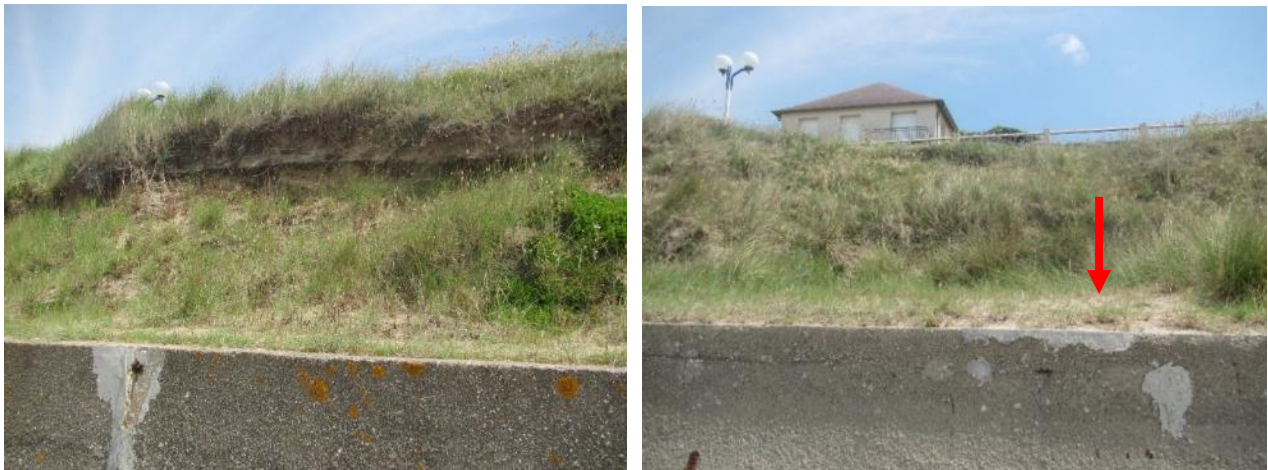
Figure 4-8 : Erosion du talus à gauche et affaissement à droite (Source : ISL)
