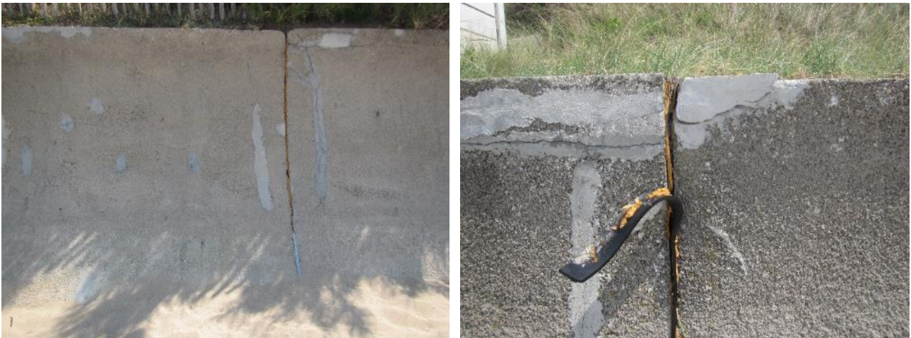
Figure 4-2 : Joints, zones de fragilité dans le perré (Source : ISL)
