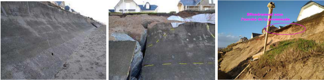
Figure 2-9 : Etat de l'ouvrage après la tempête [8]
