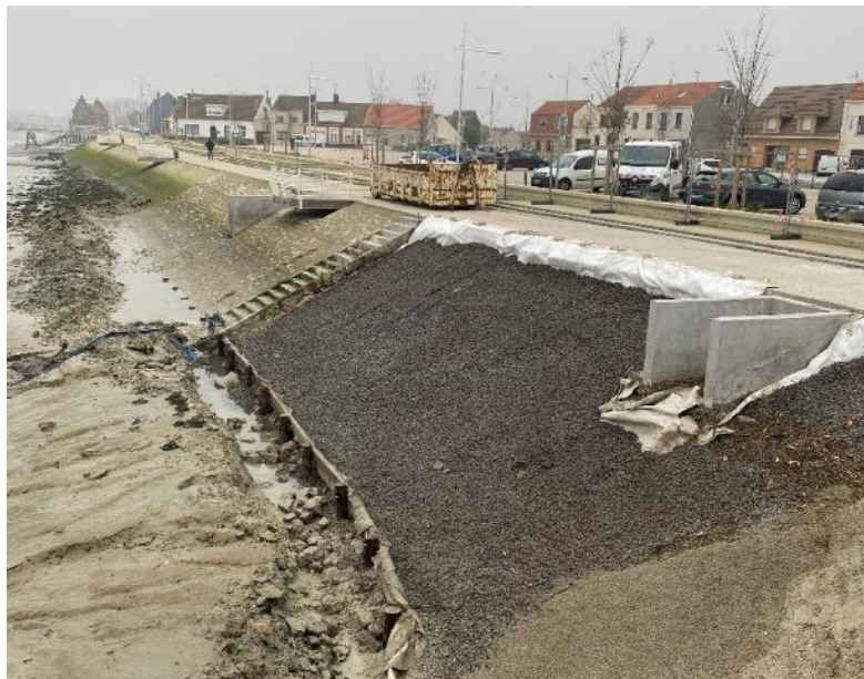
Figure 6-5 : Mise en œuvre de pieux-planches pour soutenir le pied de talus – Aa (source : photo ISL)
