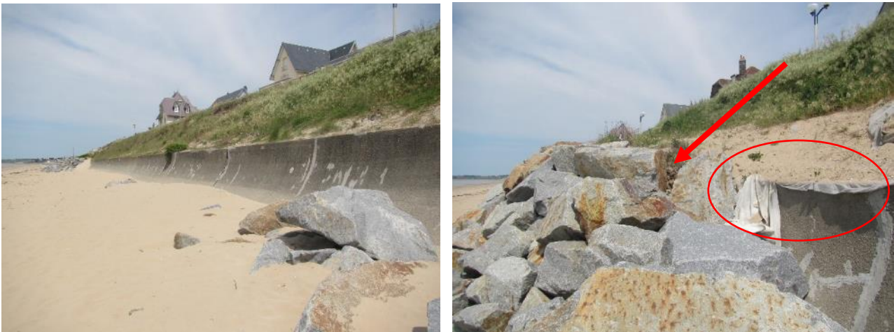
Figure 4-3 : Désordres au niveau des travaux d'urgence de 2020
