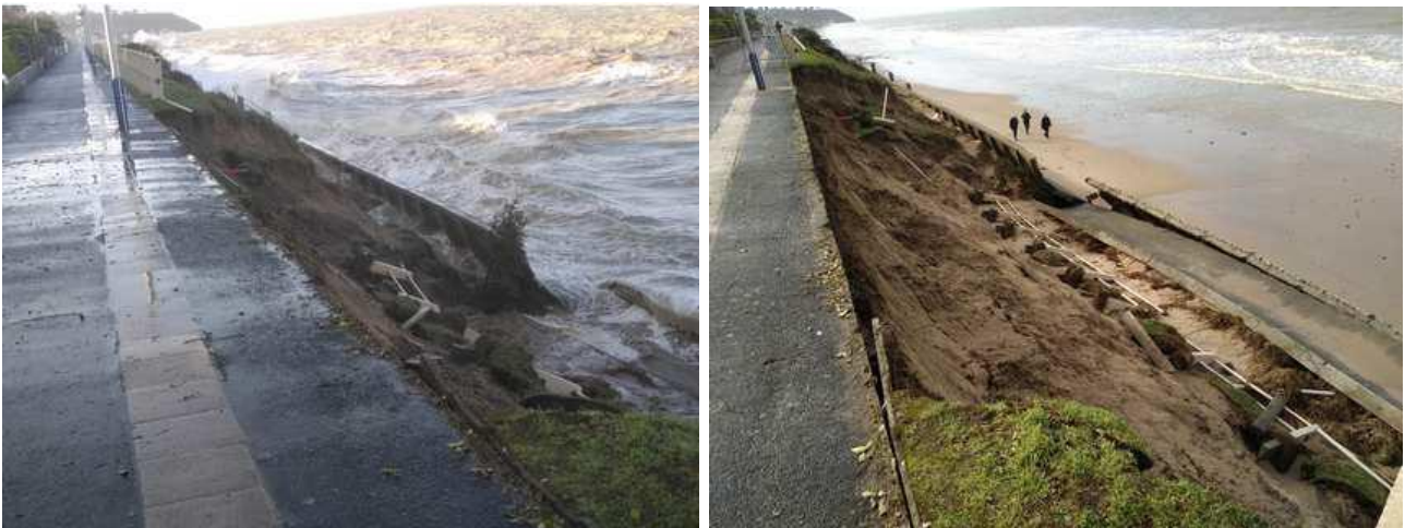
Figure 2-7 : Création d'une brèche dans le perré constatée le jeudi au matin [8]
